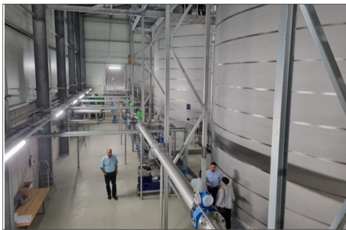
La station de Steinfeld permet de traiter et de stocker temporairement l'eau potable, et d'ajuster la pression dans le réseau. Photo DNA/Léa SCHNEIDER
